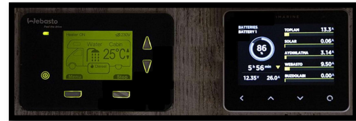
Dual Top 8 Dijital Kontrol Paneli ve Simarine Karavan Montajı
